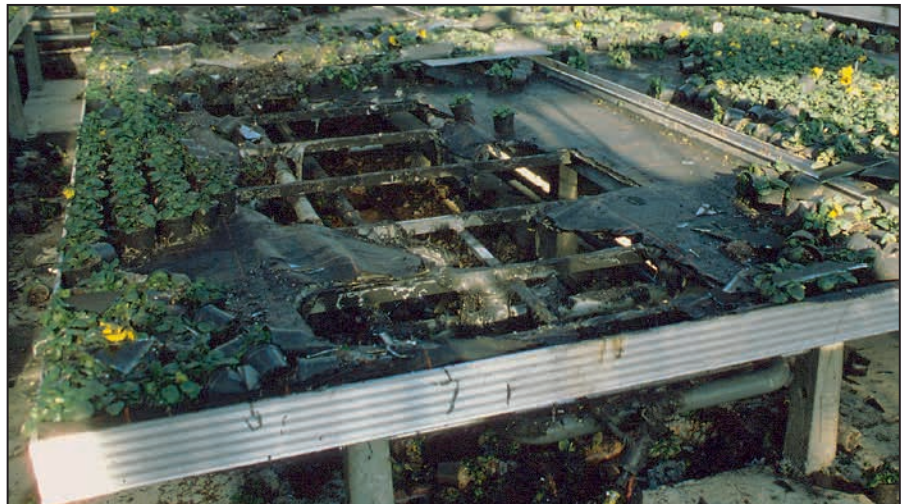
Foto 2: I rivestimenti dei bancali in materiale sintetico sono infiammabili e provocano la diffusione di fiamme.
