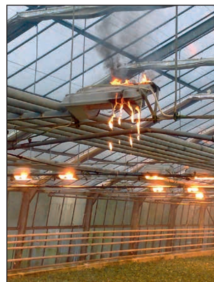
Foto 3: Incendio generato da una vecchia lampada di assimilazione. Chiaramente visibile: il gocciolamento del materiale infiammato del portalampe in plastica.
