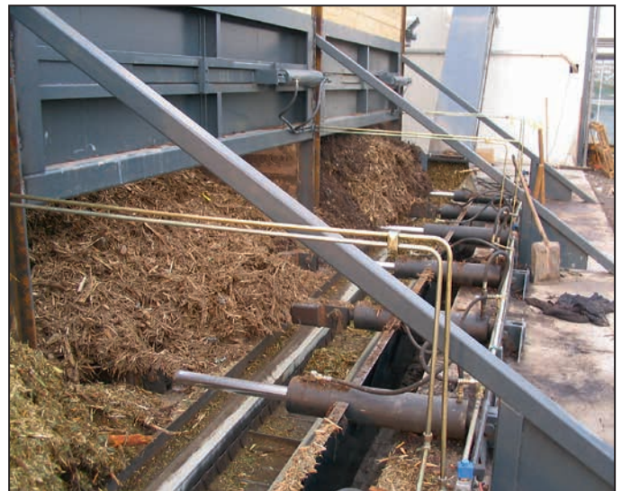
Foto 6: Dispositivi idraulici di scorrimento
