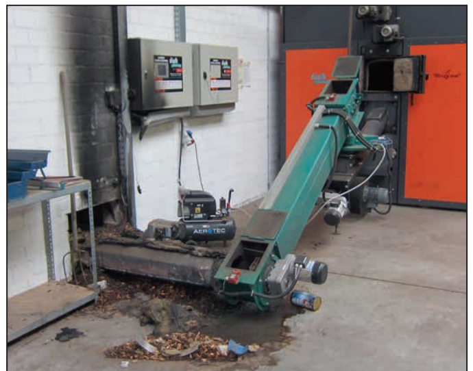
Foto 7: Ritorno di fiamma dal deposito del combustibile nel sistema di immissione
