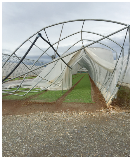
Foto 1: Tunnel singolo con tirante solo in testata; un tirante in ogni arco avrebbe ridotto gli effetti del vento sulla struttura.
